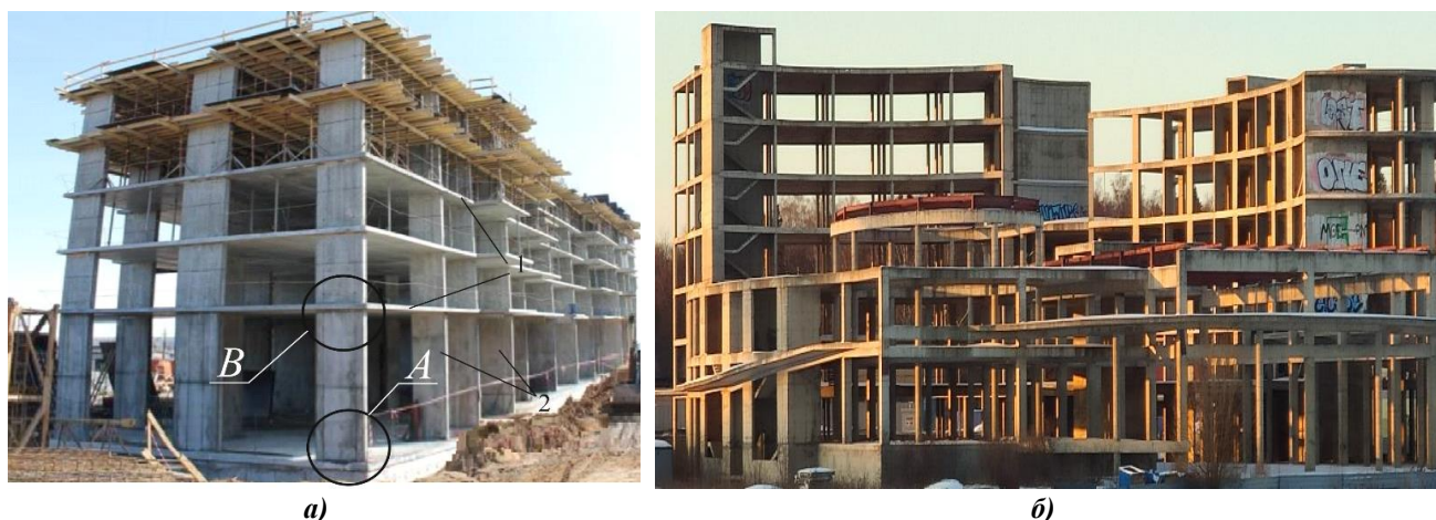
Рисунок 1 – Железобетонные каркасы зданий: с пилонами первого этажа высотой 6м (а), объект незавершенного строительства с колоннами длиной 8м в составе рам (б): А, В – узлы соединения пилон с фундаментом и с перекрытием соответственно, 1 – монолитное перекрытие, 2 – прямоугольный пилон
