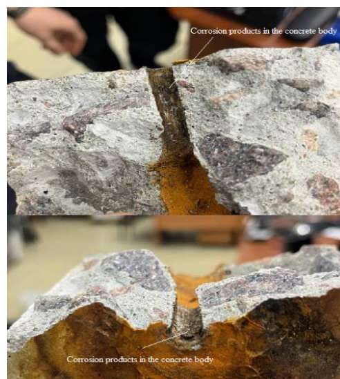
Рисунок 5 – Отслаивание продуктов коррозии в теле бетона
