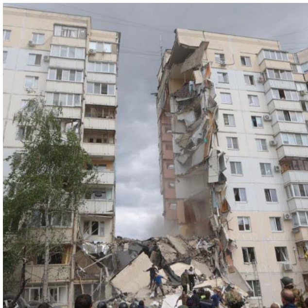
Рисунок 1 – Общий вид разрушенной секции жилого здания по ул. Щорса в г. Белгороде в результате террористической атаки 12 мая 2024 г.
