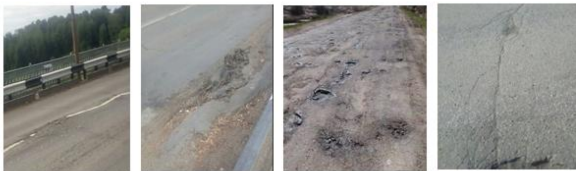
Рисунок 1 – Дефекты дорожного покрытия на дорогах общего пользования
