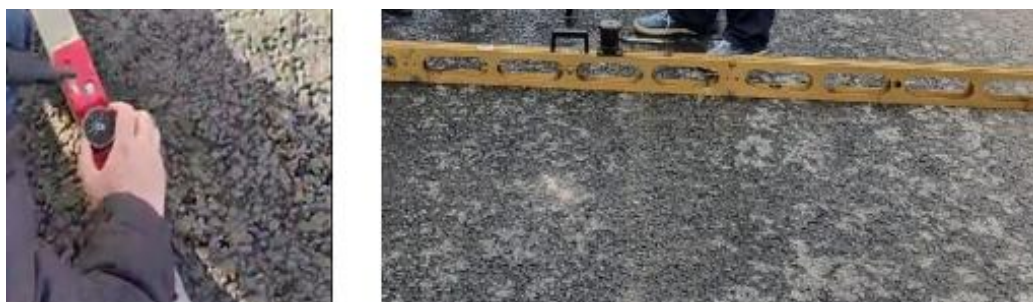
Рисунок 3 – Инструментальное измерение дефектов дорожного покрытия.
