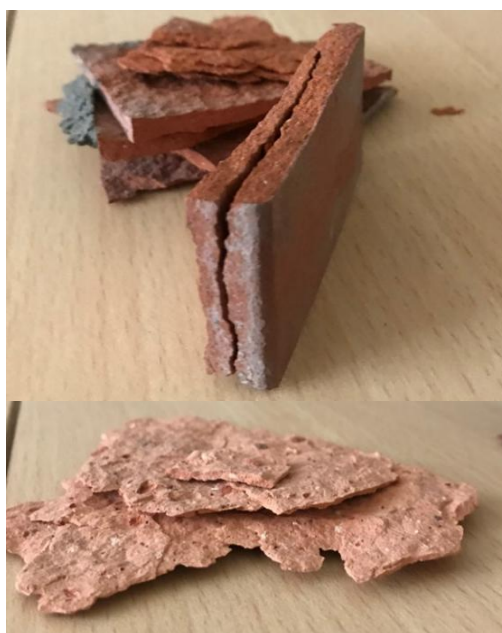
Рисунок 2 - Характер повреждений лицевого кирпича - расслоение
