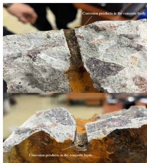
Рисунок 5 – Отслаивание продуктов коррозии в теле бетона
