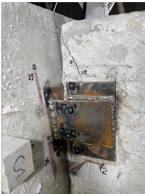
Рисунок 3 – Повреждения образцов при испытаниях на сдвиг
