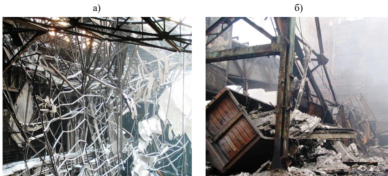
Рисунок 1 – Последствия коррозионного разрушения конструкций и сооружений: а) аварийное разрушение покрытия прокатного цеха; б) обрушение транспортной галереи углеподготовки
