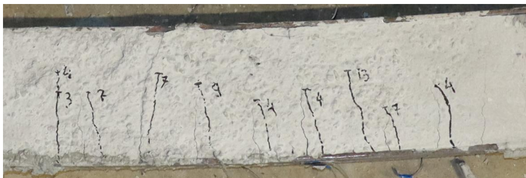
Рисунок 8 – Характерный вид разрушенных моделей М2.1...М2.3: а) общий вид модели под нагрузкой перед разрушением; б) характерные трещины в середине пролёта балки
