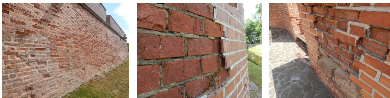
Рисунок 1 – Выкрашивание керамического кирпича после реставрации исторической кладки
