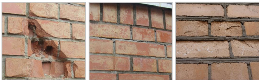
Рисунок 1 - Дефекты наружного слоя кирпичной кладки
