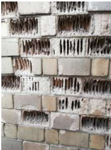
Рисунок 2 – Типичное разрушение наружной стены из пустотелого кирпича
