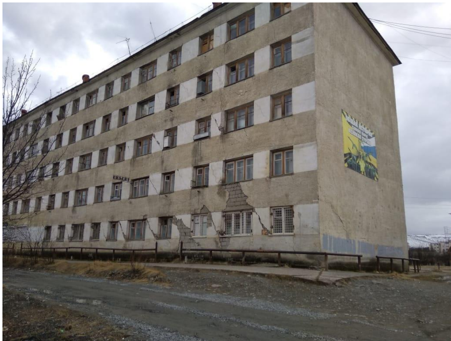
Рисунок 1 – Повреждения здания вследствие деградации вечномёрзлых грунтов на Чукотке (фото: Сушев Л.А.)
