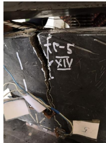
Рисунок 3 - Трещина в балке в момент разрушения
