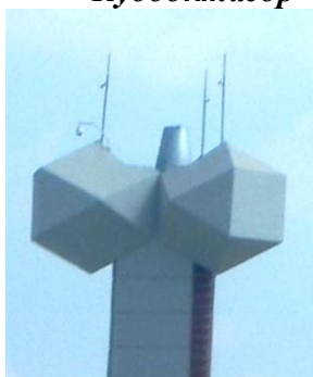
Рисунок 28 - Два кубооктаэдра на трубе, Израиль
